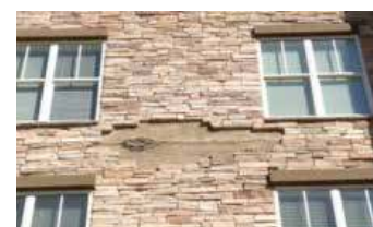
Fallas de adherencia
