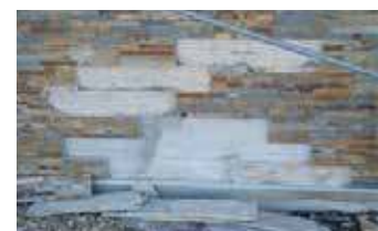
Delaminación de la piedra
